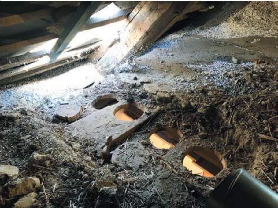
11. kép • A légtechnika átvezetése készül a padlásdeszkázaton a négy darab kerek kivágaton át. Megfigyelhető a szalmaterítésre tett kb. 10 cm vastag sarazás, amit a csövek átvezetése után helyreállítottunk.
