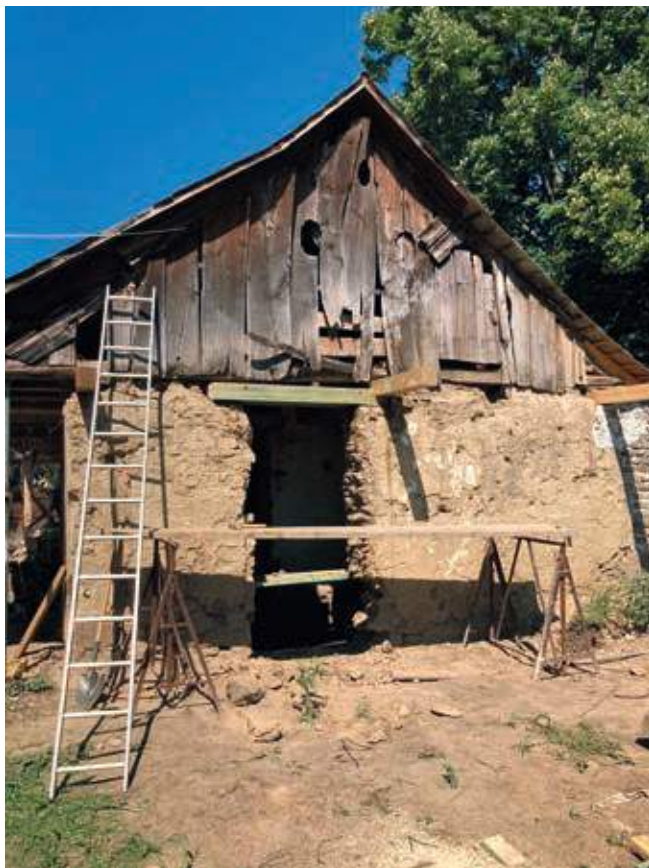
14. kép • Nyílásbontás Lovasberényben, a déli homlokzaton, ugyanis itt egyetlen ablak sem volt. Itt csatlakozott az épülethez a megsemmisült istálló. A fal állékonysága lehetővé tette a teljes átvágást, majd utólag épültek be fa áthidaló gerendák.
