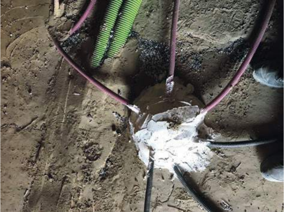
12. kép • Sarazásfelújítás a 200 éves házban. Az elektromos és légtechnikai csövek beszerelése után a sarazás helyreállítása agyagtapasztással, az elektromos átvezetésnél a gégecsövek körül gipszeléssel.
